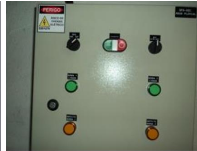
Quadro de comando do sistema de recalque
