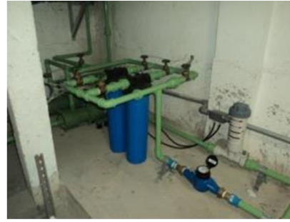
Prédio 2 - sistema de recalque para reservatório superior utilizada filtragem e cloração
