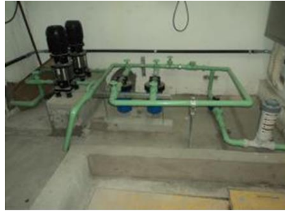
Prédio 1 - sistema de recalque para reservatório superior utilizada filtragem e cloração
