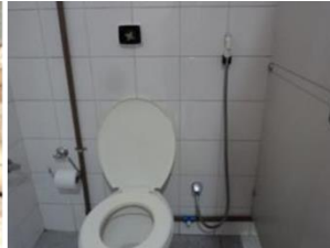
Bacia sanitária alimentada com água das chuvas – ducha higiênica alimentada com água limpa/Sabesp, por tubulação aparente.
