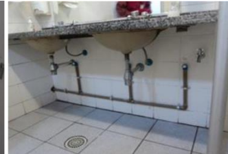
Conjunto de lavatórios alimentados com água limpa/Sabesp; tubulação aparente conduzindo água limpa
