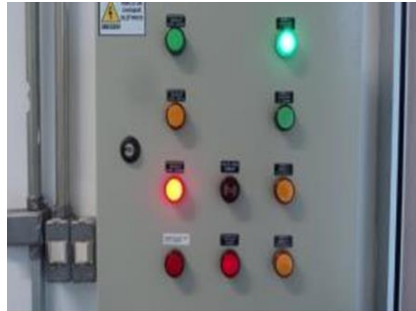
Quadro de automação com indicação da operação do sistema
