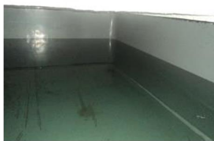
Reservatórios impermeabilizados com manta atóxica
