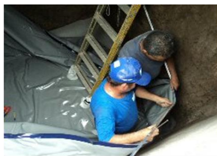
Recuperação de reservatórios inferiores e superiores - processo de impermeabilização por meio de manta atóxica
