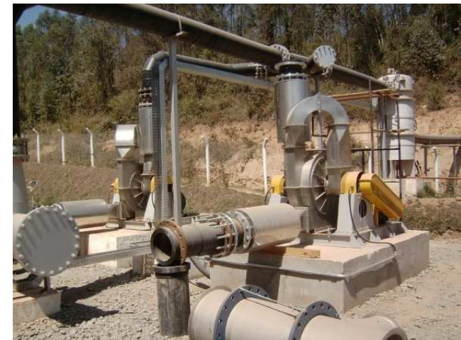
Sistema de extração de biogás – Aterro Bandeirantes, São Paulo
