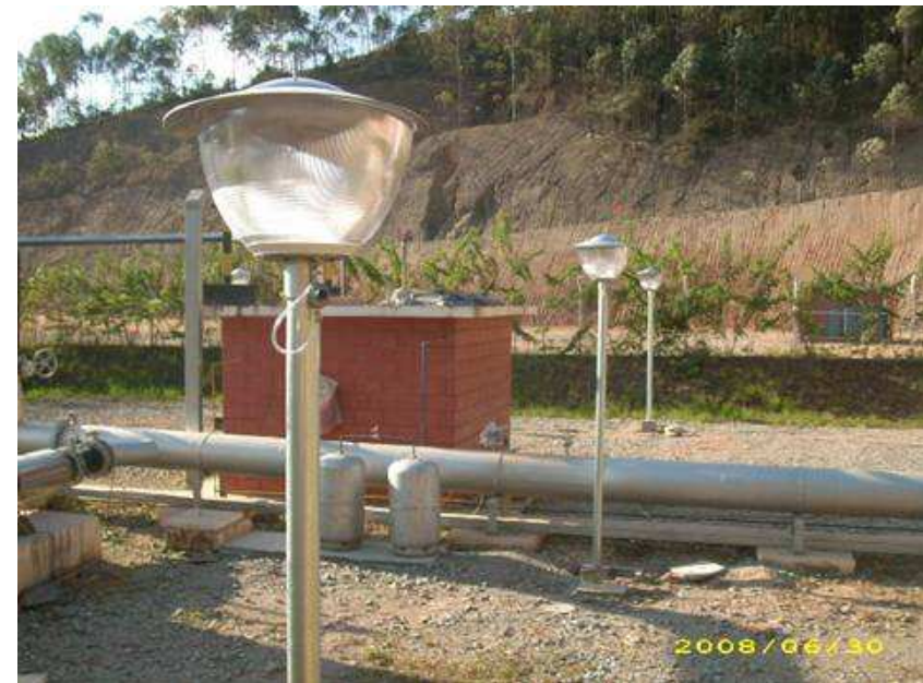
Poste de iluminação a gás do aterro de Caieiras, SP (foto: Vanessa Pecora, CENBIO)
