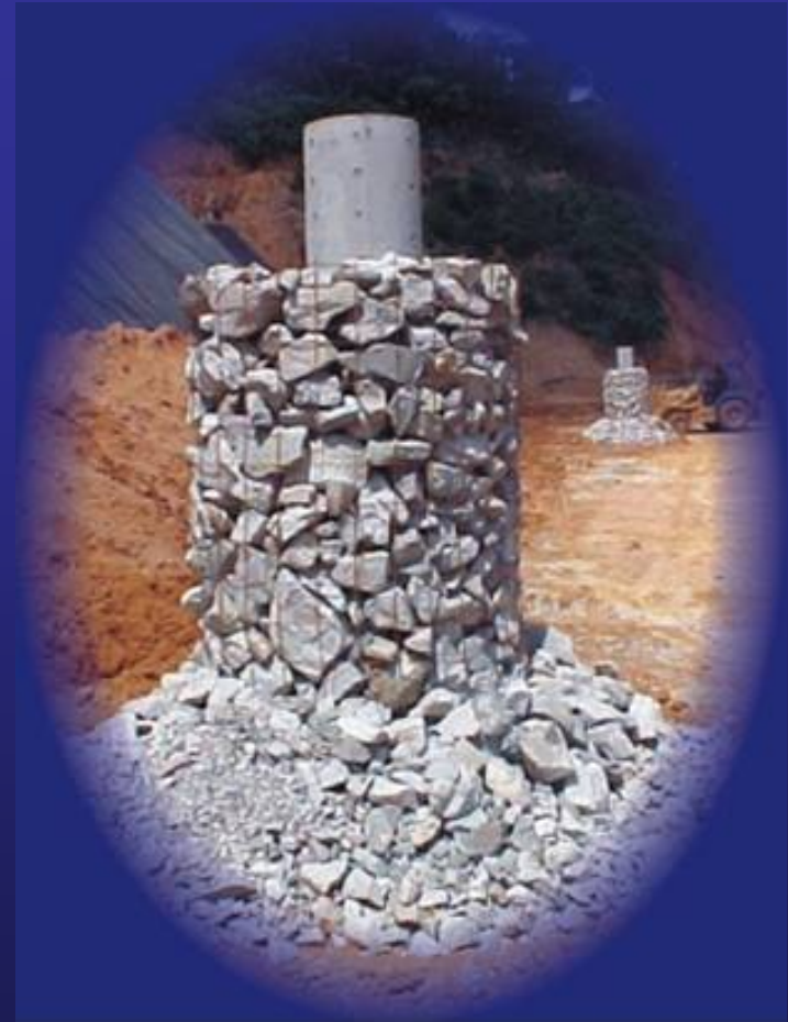
Dreno Vertical de Biogás e Chorume
