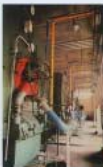
Unidade de bombeamento de biogás Unidad de bombeo de biogás
