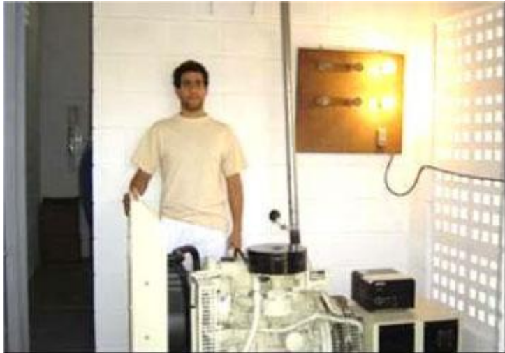
Figura 16- Grupo Gerador (COELHO et al, 2005).
