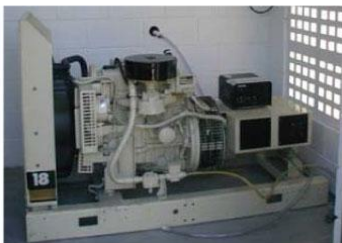
Figura 9- Grupo Motor-gerador (COELHO et al, 2005).
