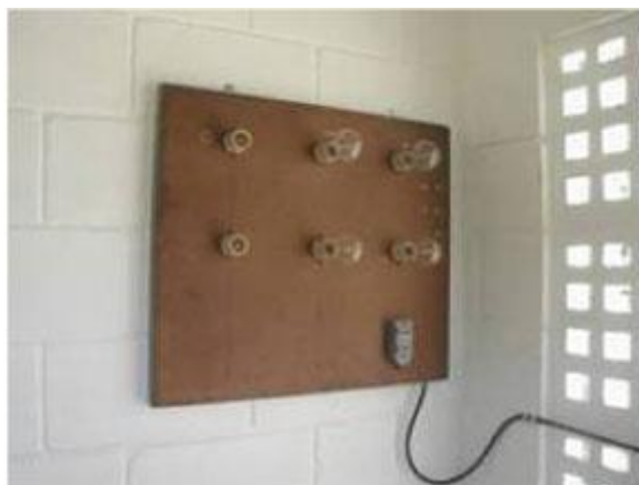
Figura 17- Painel de Teste do Grupo Gerador (COELHO et al, 2005).
