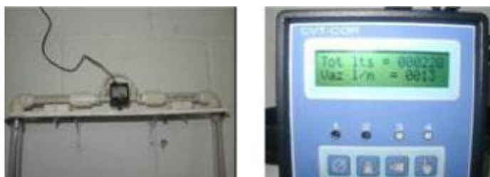
Figuras 12 e 13- Sensor-totalizador de Vazão Instalado no Abrigo (COELHO et al, 2005).
