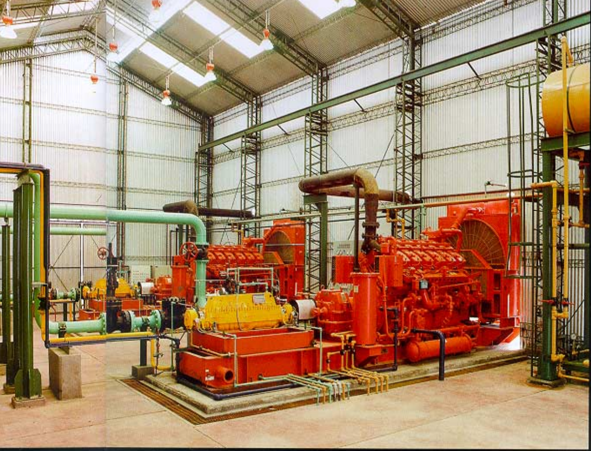
Dois motores Waukesha L7042G acionam bombas centrífugas @ 900 rpm em Santa Cruz, Argentina.
