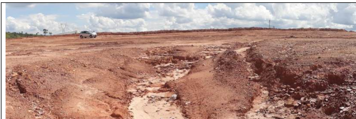
sulco de erosão em área de aterro, com material não compactado
