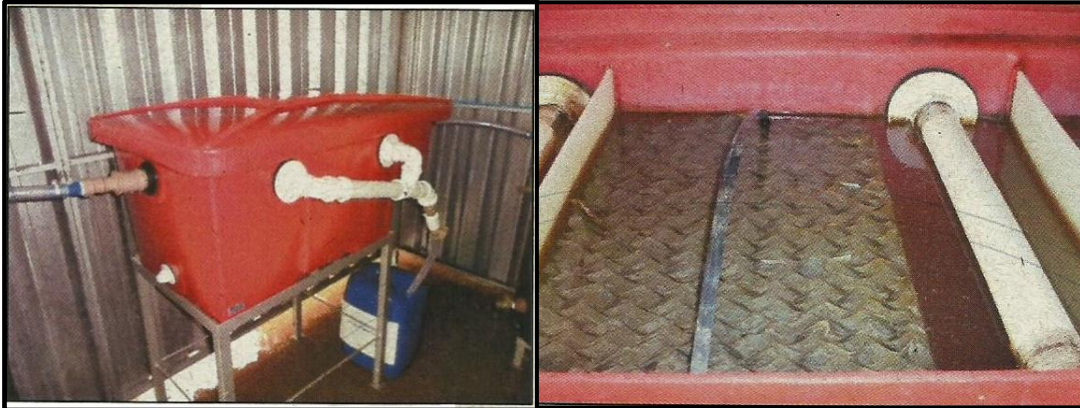
Figura 14: Caixa separadora de água e óleo Fonte: Relatório CETESB 2010.
