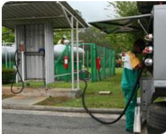
Figura 8 - Sistema para reabastecimento de empilhadeiras
