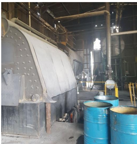
Figura 49 – Fornalha Caldeira VATI.
