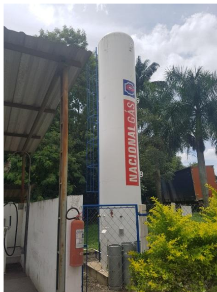
Figura 42 – Tanque de GLP
