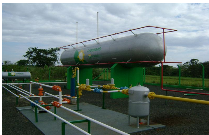
Figura 11 - Dispositivos e acessórios do tanque de GLP
