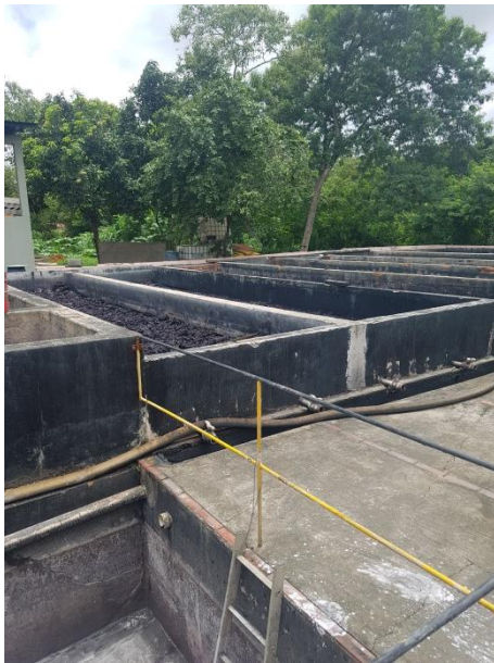
Figura 45 – Caixas de tratamento de lodo – processo de secagem
