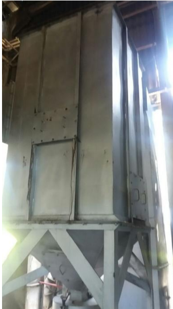
Figura 51 – Filtro Muticiclone vista lateral (Acoplado Caldeira VATI)
