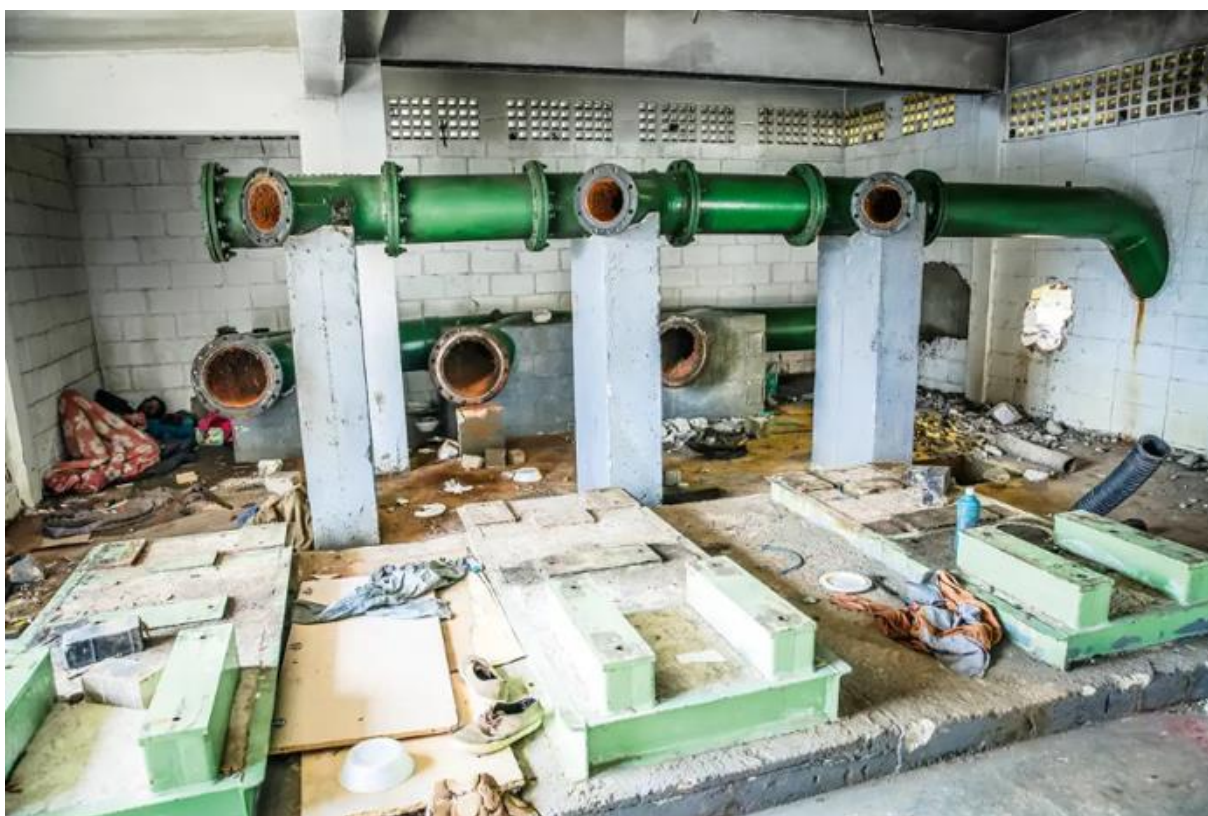
FIGURA 3 - VANDALISMO NA EEE VARGINHA
