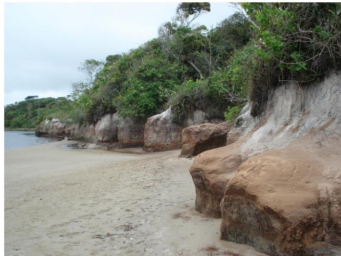
Figuras 6. Indicadores III e IV de erosão costeira (fotos da autora).
